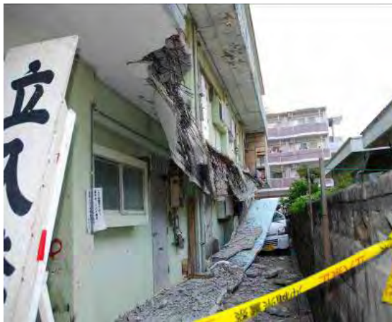
写真 外廊下崩落現場
