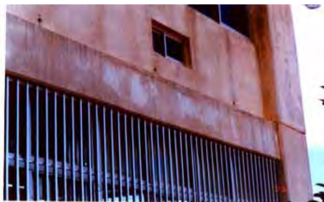
写真3 柱・梁の外来塩害
