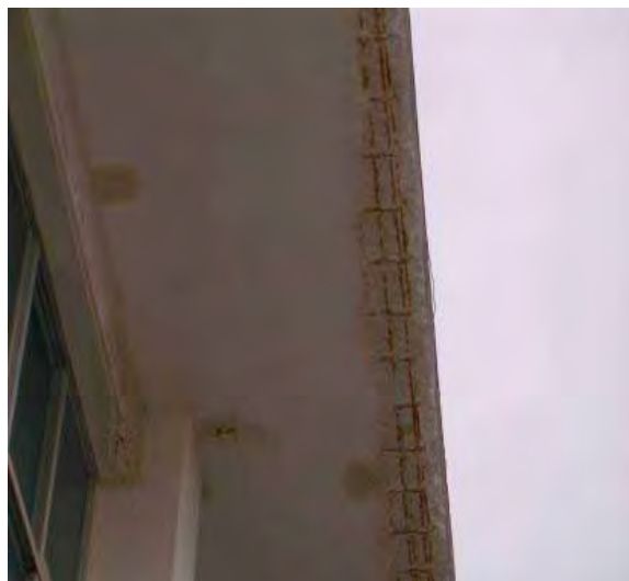
写真2 軒下の内部塩害例
